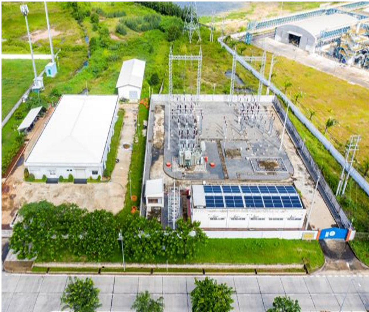
Hình 5. Trạm điện KCNCS Phú Mỹ 3.
